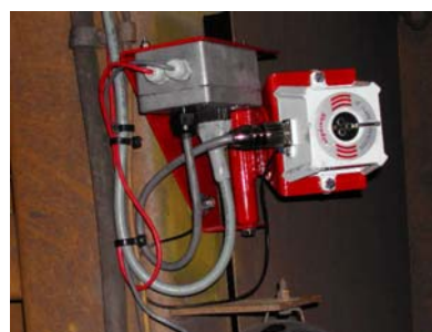
Infrarot Melder zur automatischen Auslösung der Löschanlage.
